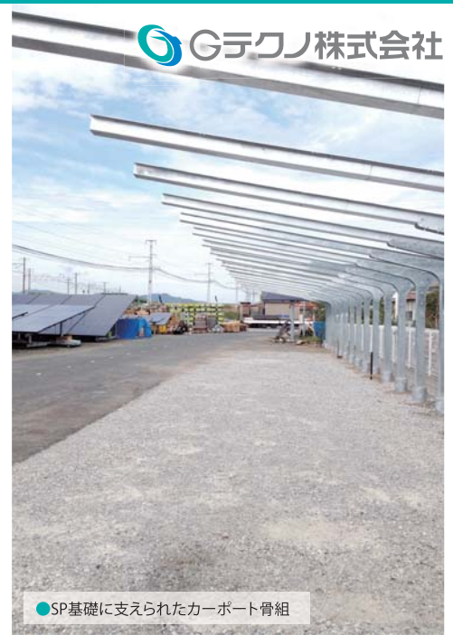
●SP基礎から立上げカーポートとして設置された約8KWのソーラー屋根(延長16m×幅3.2)
