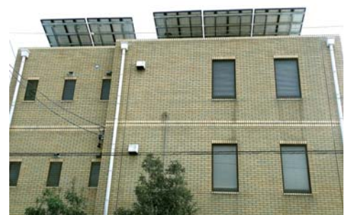
設置例：屋上（愛知県豊川市）
