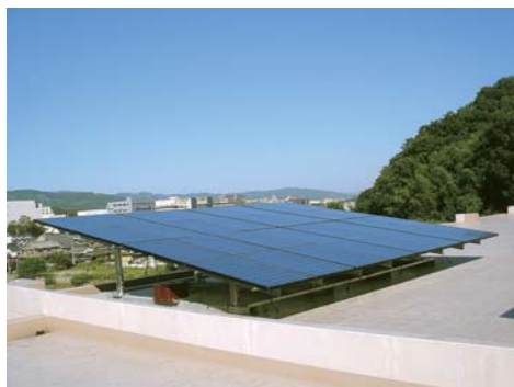
設置例：屋上（大阪府茨木市）
