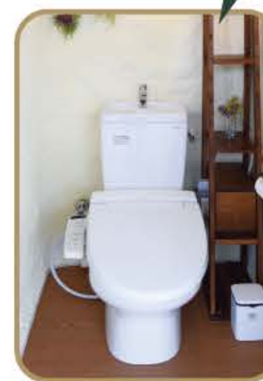
温水洗浄便座付き便器
