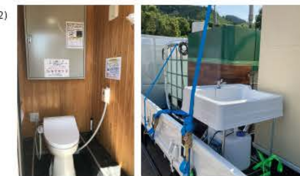
節水式洋便器 手洗い台
